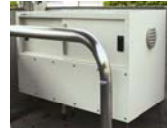
<リチウムイオン蓄電池>
