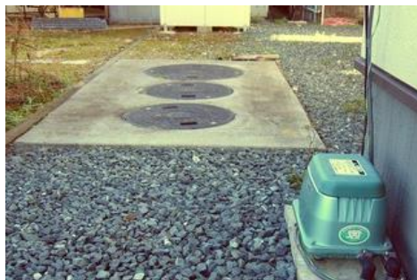
じょうかそう 浄化槽とブロー じょうかそう 浄化槽は地下にあるので、見える ちか のは、フタだけです。近くには、 ブローとよばれるび生物に空気を 送る機械があります。
