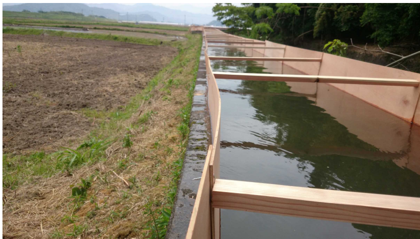
図4-6 合板で応急処置を行った水路
