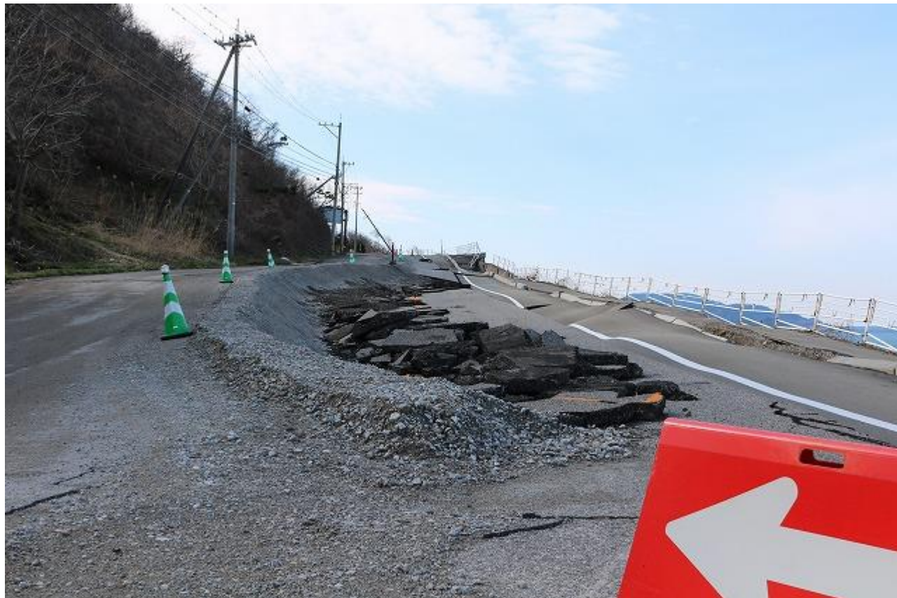
国道249号 路肩の崩落状況③
