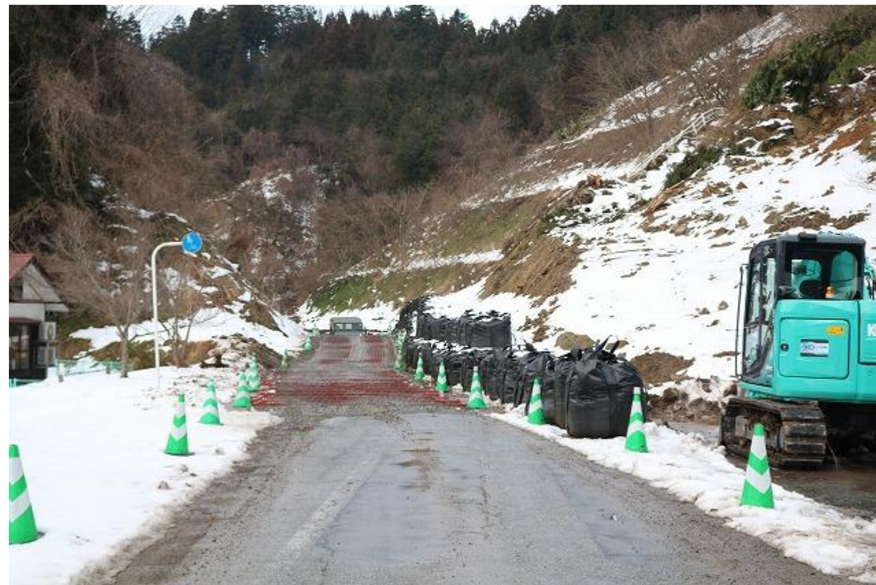
県道 1 号線 法面の崩壊状況②
