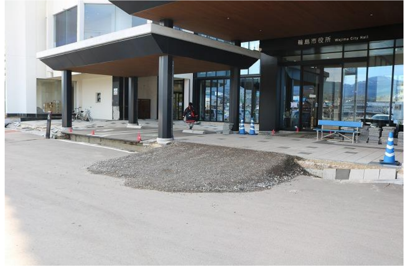
輪島市役所 被災状況①
