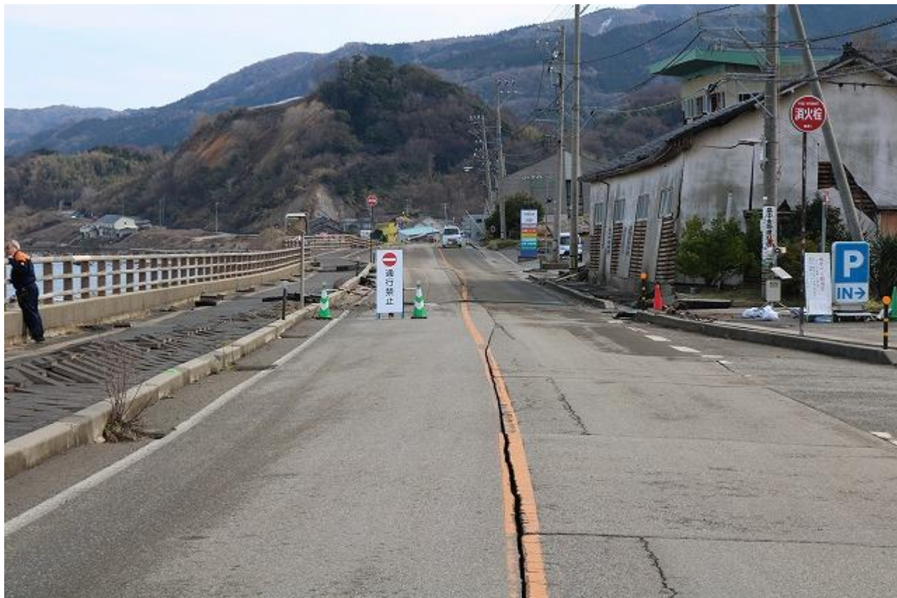
国道 2 4 9 号 マンホールの浮き上がり状況①
