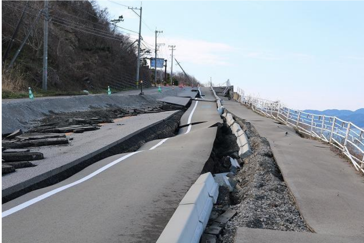
国道249号 路肩の崩落状況①
