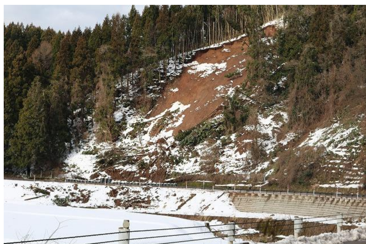
県道 3 7 号線 法面の崩壊状況
