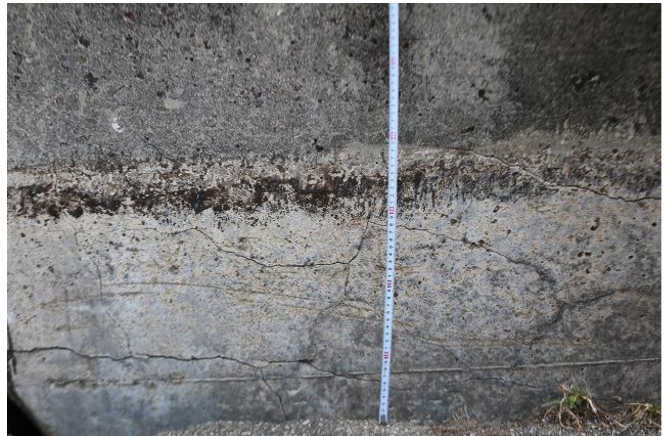
国道 2 4 9 号 橋梁取合部の段差発生状況②
