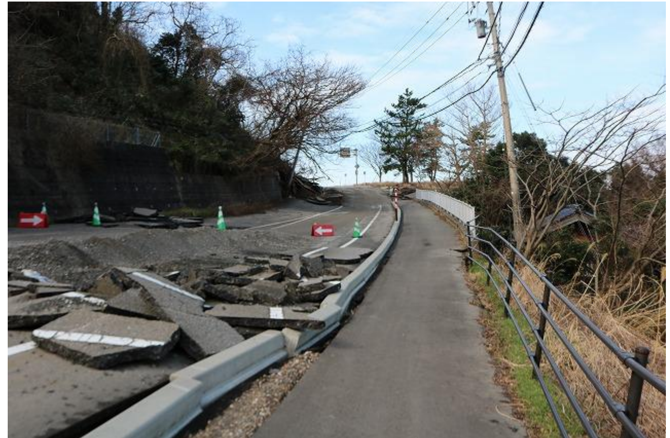
国道249号 路肩の崩落状況②
