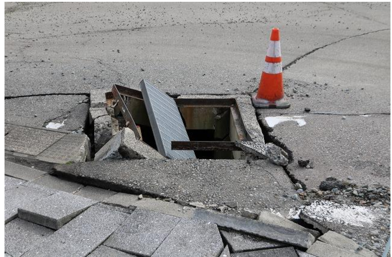
県道 1 号線 マンホールの浮き上がり状況②
