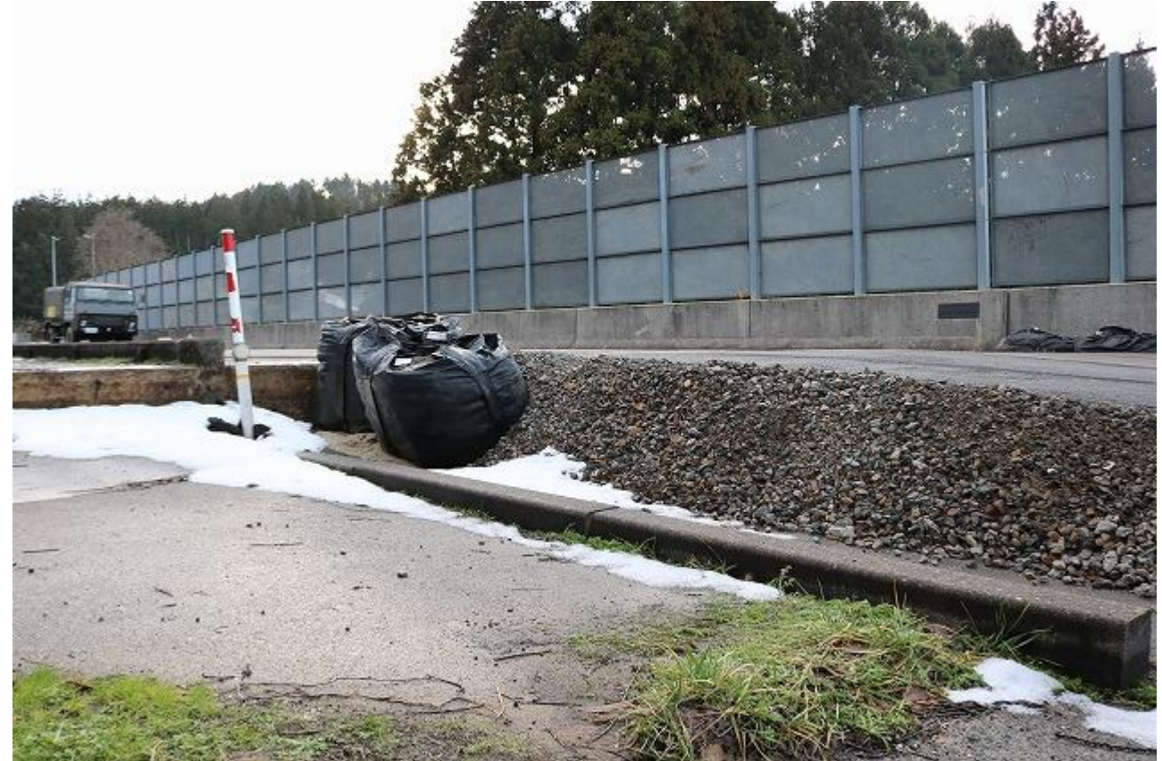
県道 1 号線 橋梁取合部の段差発生状況②
