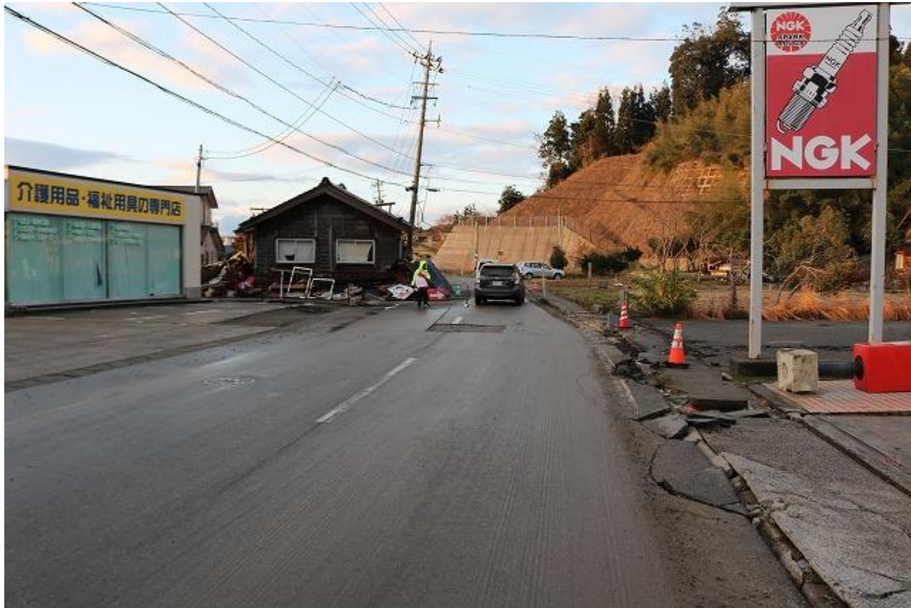
県道 1 号線 建物の倒壊状況①
