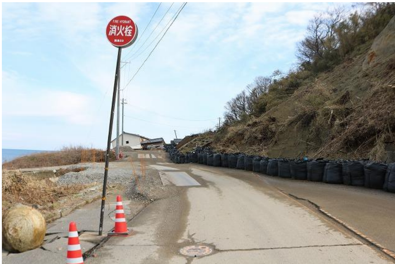
国道 2 4 9 号 法面の崩壊状況
