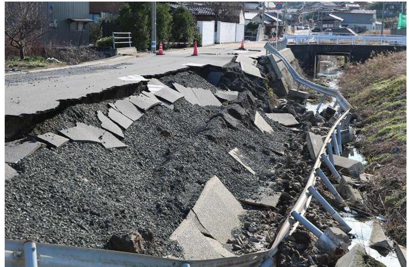
輪島市道 路肩の崩落状況
