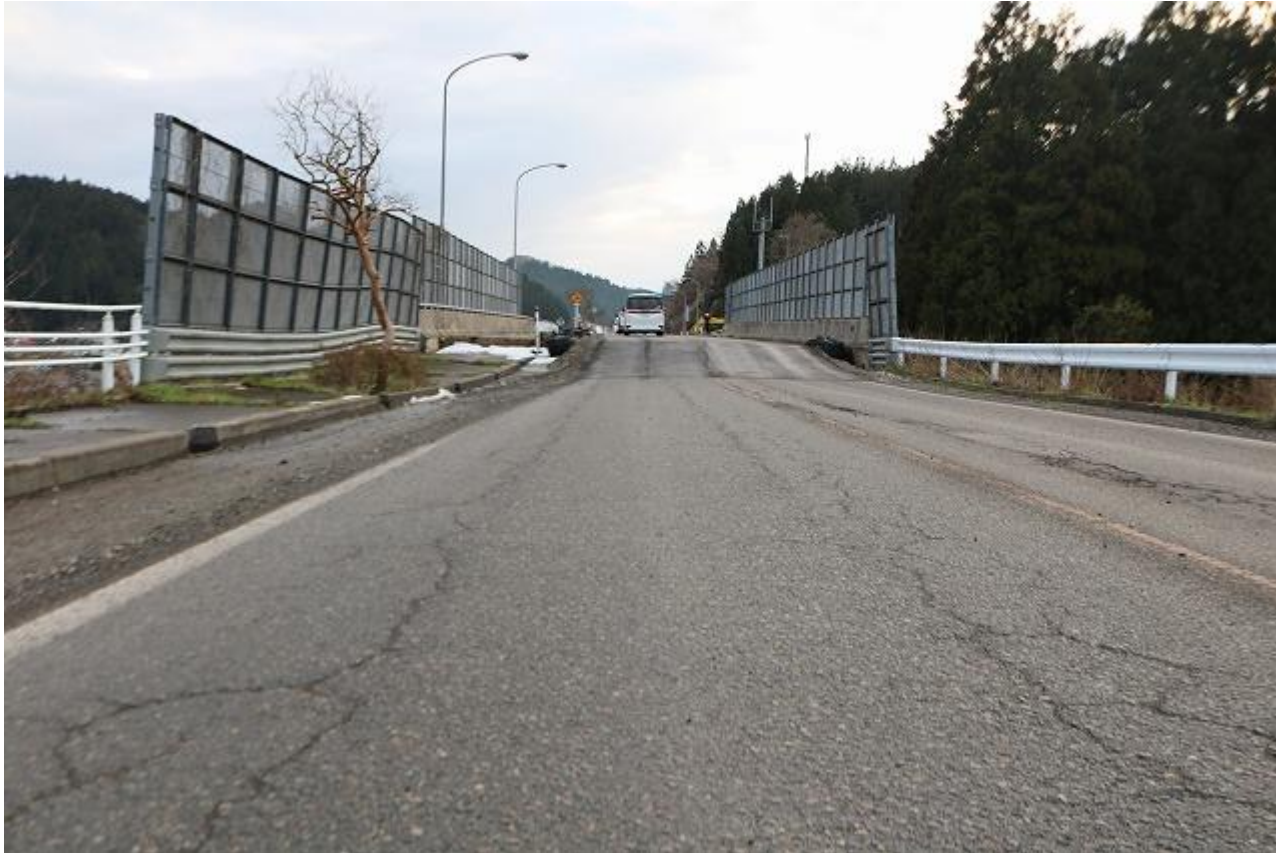
県道 1 号線 橋梁取合部の段差発生状況①
