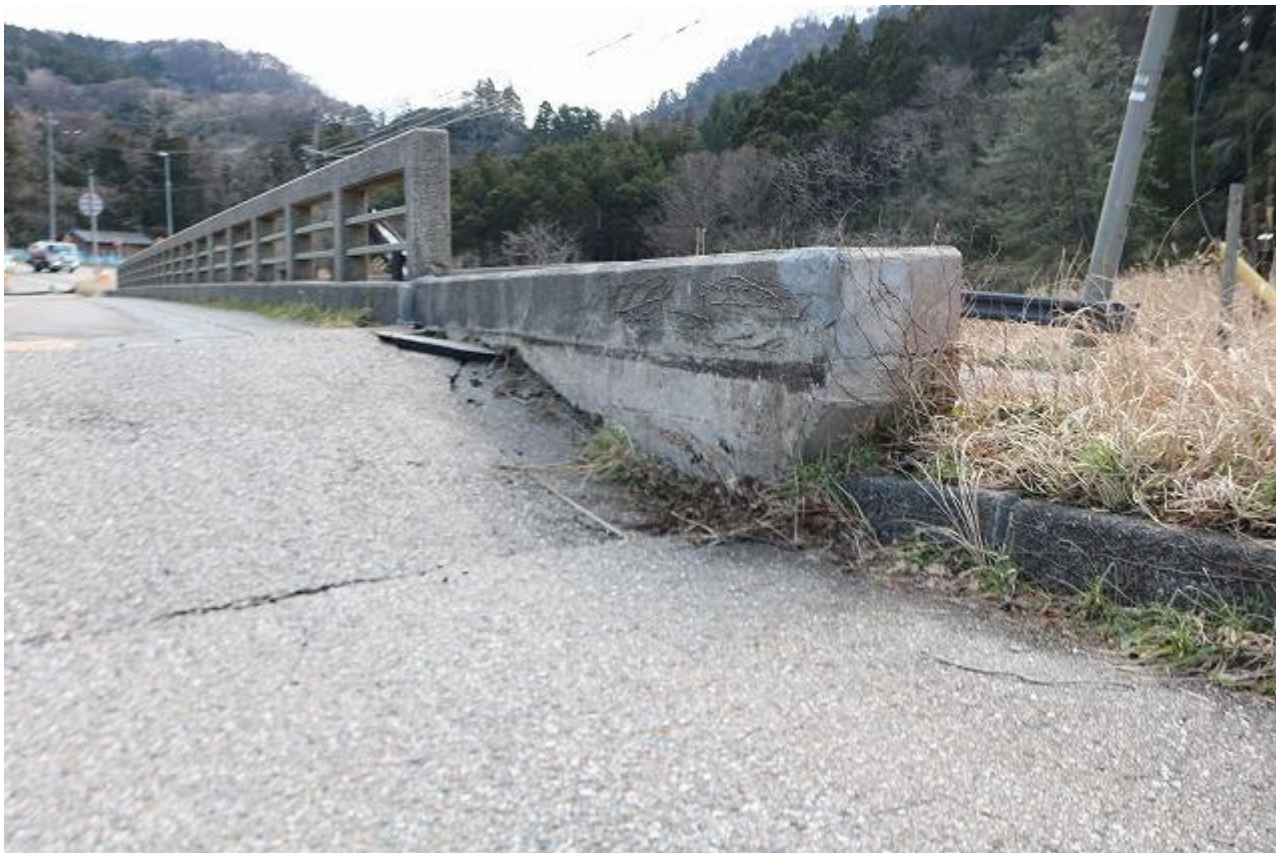
国道 2 4 9 号 橋梁取合部の段差発生状況①
