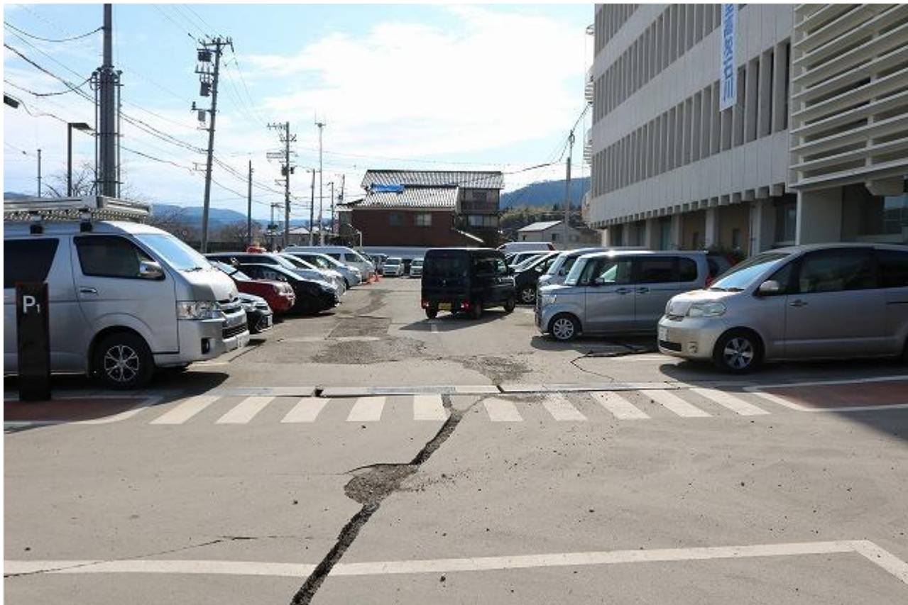
輪島市役所 被災状況②
