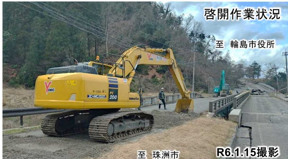
写真 橋梁との段差解消（石川県輪島市）
