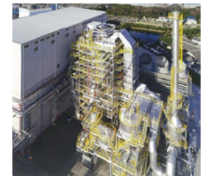
バイオマスボイラー・発電
