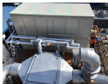
バイナリー発電設備
