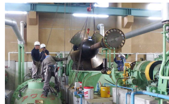
【堀江地区 農業用排水機場 老朽化対策(鳴門市)】
