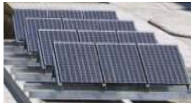
屋上太陽光発電
