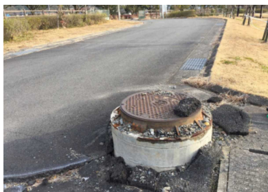
平成28年熊本地震 体育館周りの隆起したマンホール 出典：熊本災害デジタルアーカイブ 提供者：熊本県益城町
