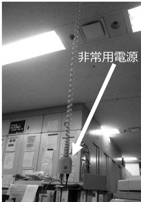
図表 7.2 非常用電源（例）
