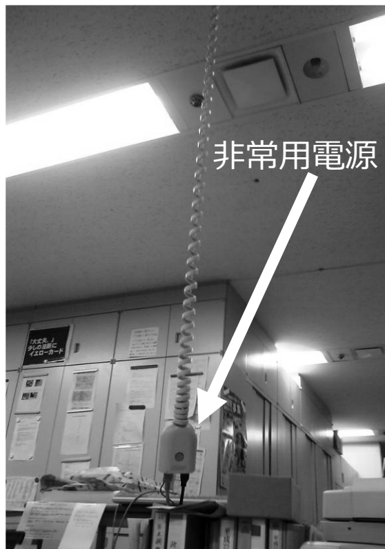
図 5.1 非常用電源（例）
