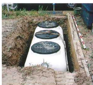
写真：設置状況
