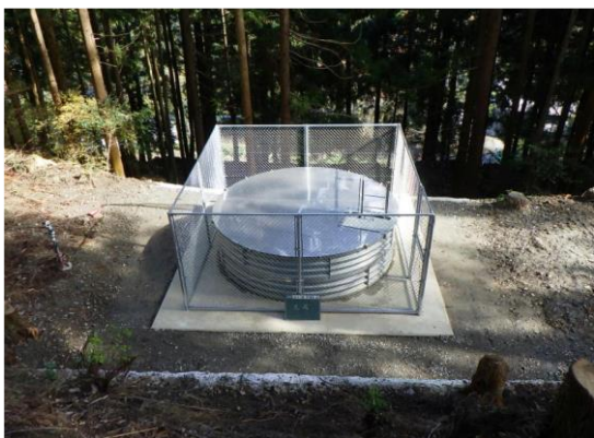
地すべりの原因となる地下水を排除する集水井工
