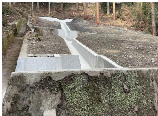
雨水等を速やかに地すべり区域外へ排水
