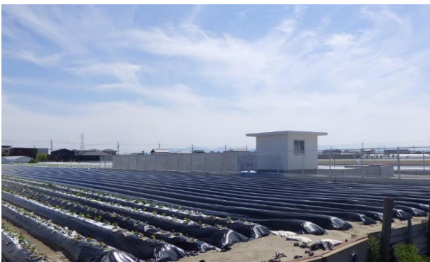
揚水機場と調整水槽(大津東部東2期地区)
