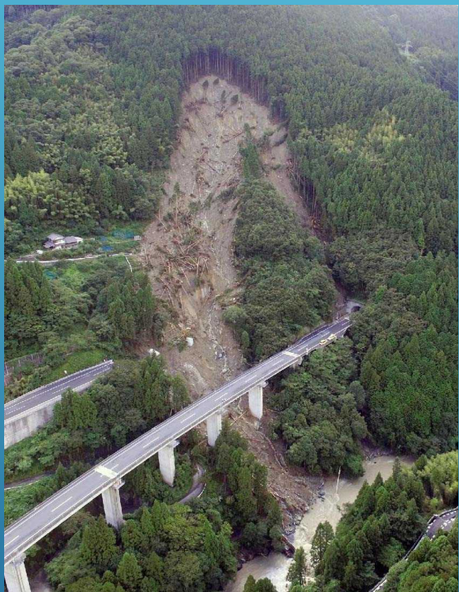
立川千本地区の斜面崩壊と上部工破損状況 (高知新聞)
