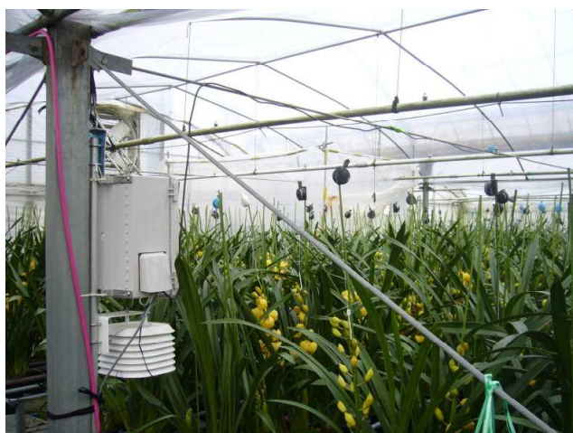
B地点 センサ設置状況
