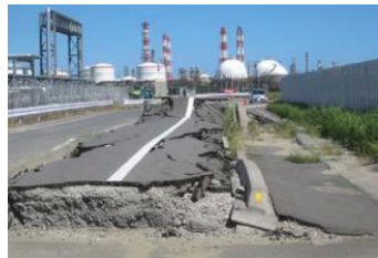
液状化による道路被災例 (2011 鹿島港)
