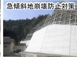
川ヨリ西急傾斜地崩壊危険区域
