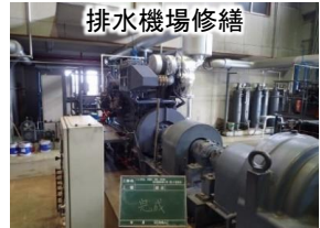
打樋川排水機場
