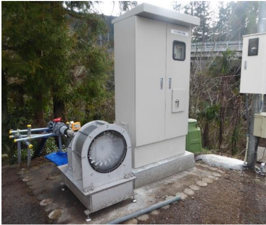
装置全景(防音ボックス無し)
