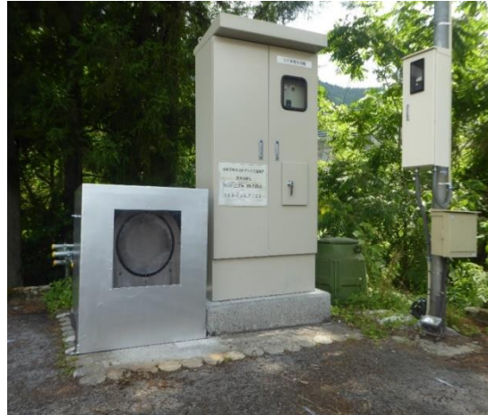
装置全景(防音ボックス有り)
