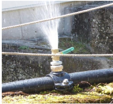
取付後の空気抜き弁
