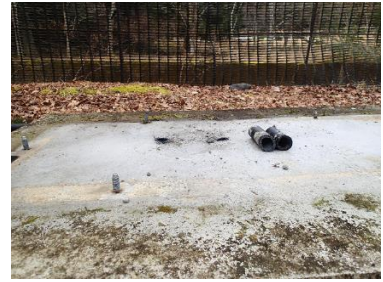
基礎部の電線管切断
