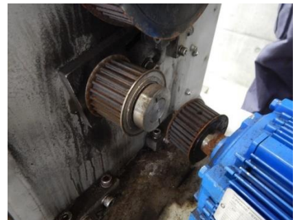
伝動プーリー部
