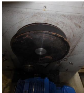
伝動プーリー部
