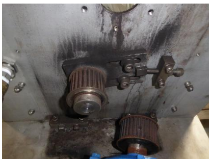
テンションプーリー部
