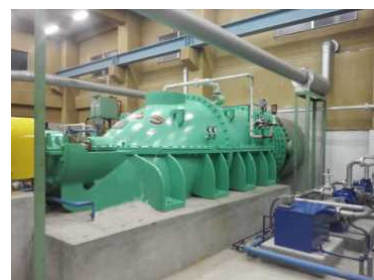
オーバーホールされた排水ポンプ (堀江排水機場)
