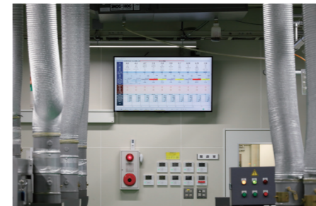
工場内モニタ(生産状況の可視化)
