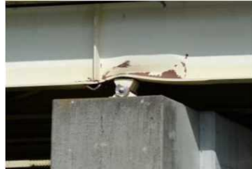
【支承損傷による桁の変形】
