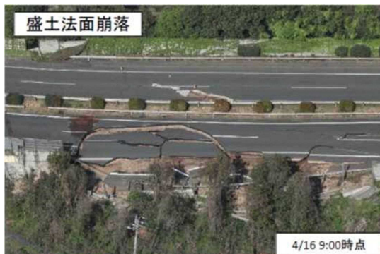
出典：熊本地震による被災及び復旧状況資料 国土交通省 HP
