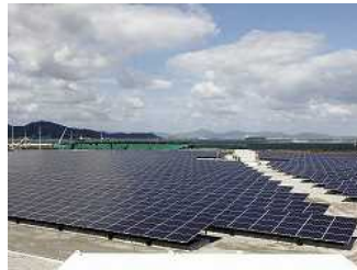
※企業局和田島太陽光発電所
