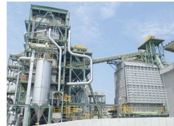
※クラボウ徳島バイオマス発電所
