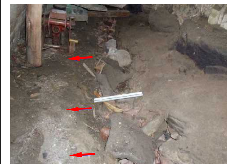
② 民家土間コンクリートの開き (開口部に礫投入)
