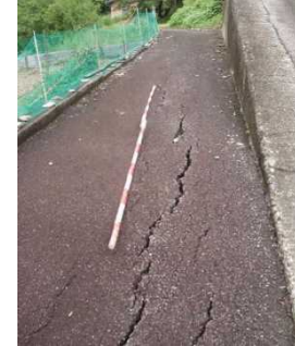
① 路面の損傷状況
