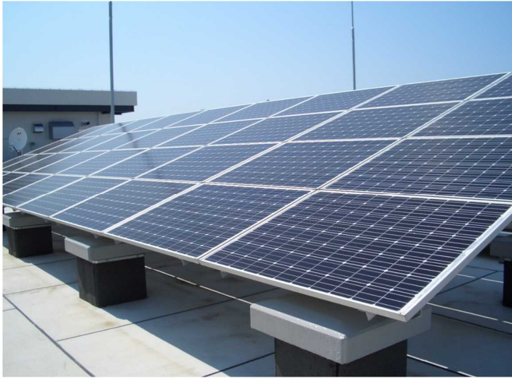
太陽光パネル
