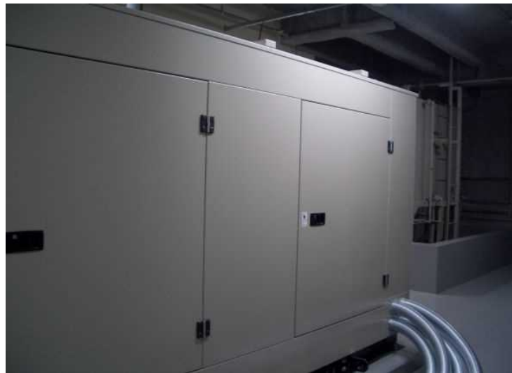
非常用発電機
