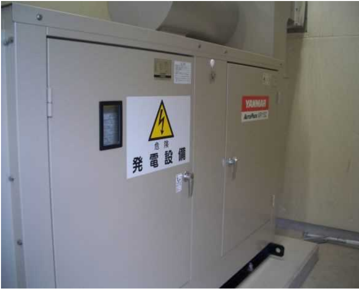
自家発電装置
