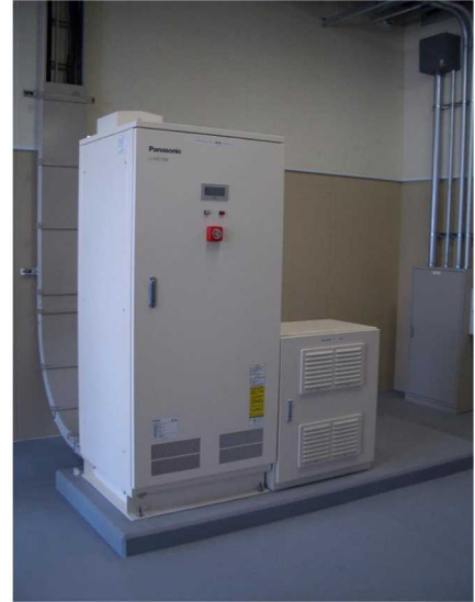
蓄電システム
