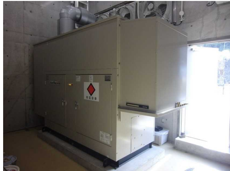
自家発電設備
