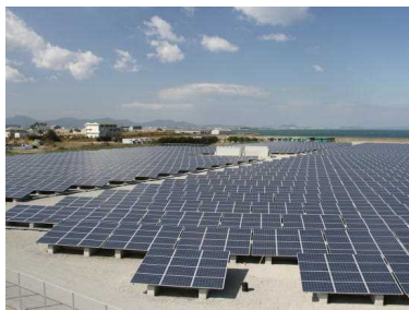
マリンピア沖洲太陽光発電所
