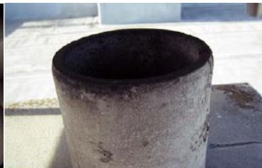
煙突の内側に使用 石綿含有断熱材
