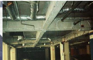
鉄骨を被覆して保護 石綿含有耐火被覆材
