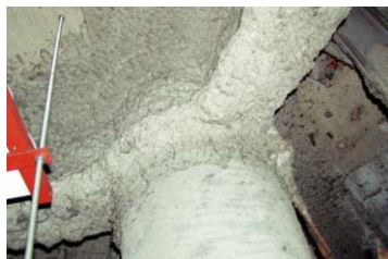
柱や梁に施工 吹付け石綿
