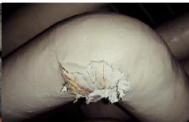
エルボ部に使用 石綿含有保温材
