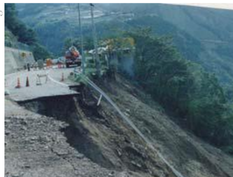
【国道32号三好市 (猪ノ鼻峠) 被災状況 (H2.9)】
