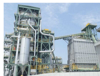
※クラボウ徳島バイオマス発電所
