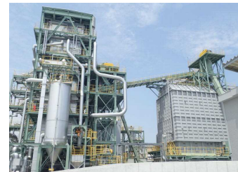
※クラボウ徳島バイオマス発電所
