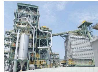
※クラボウ徳島バイオマス発電所
