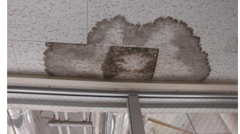
雨漏りによる天井材の落下
