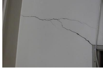
外壁のひび割れ
