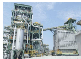
※クラボウ徳島バイオマス発電所
