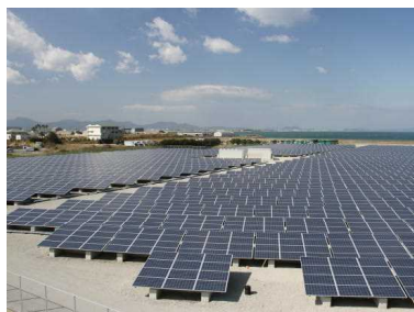
マリンピア沖洲太陽光発電所
