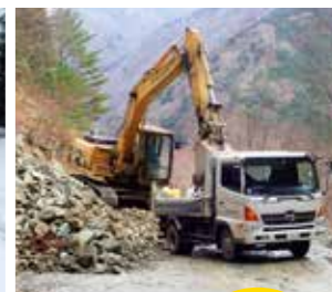
崩落した土砂の撤去
