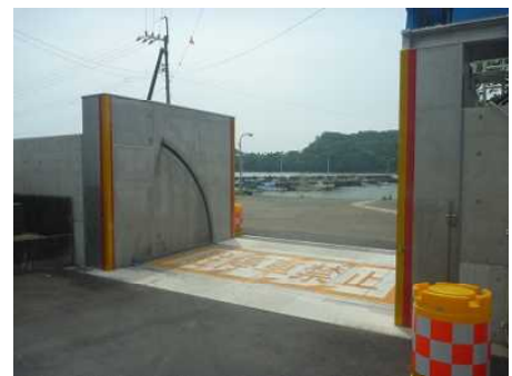
浅川港海岸自動開閉陸閘
