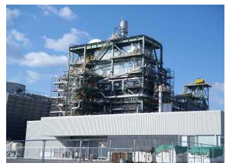
バイオマス発電所（クラボウ）
