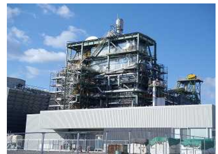
バイオマス発電所（クラボウ）
