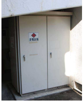
高圧受電設備(キュービクル)
