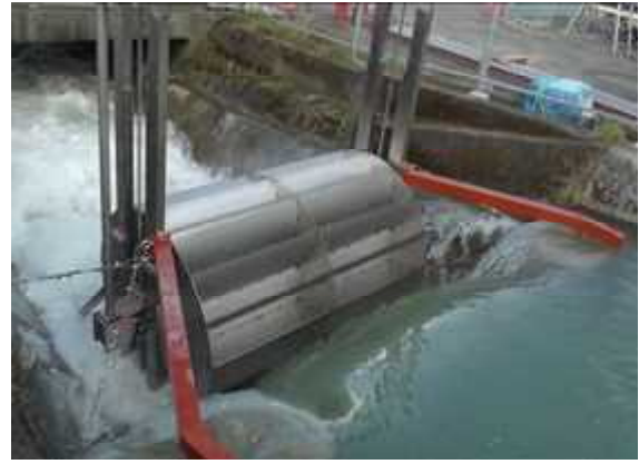
小水力発電施設
