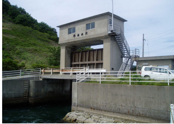
自動化された水門
