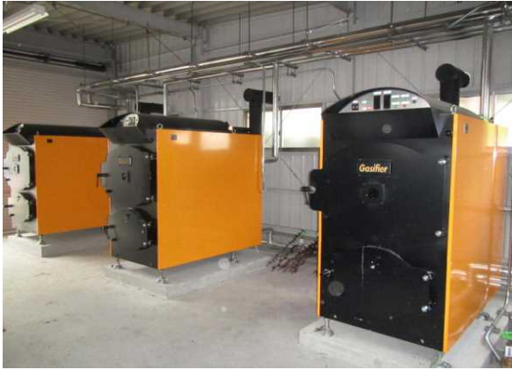
木質バイオマスボイラー
