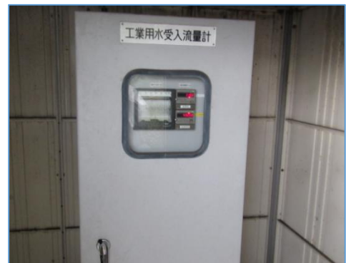
施策4-3 正確な水利用を把握するために設置された流量計
