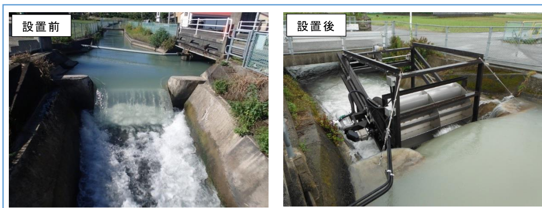
施策3-1 水路に設置した小水力発電装置(那賀川南岸土地改良区)
