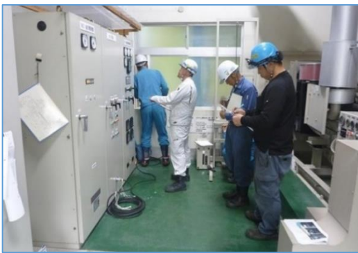
施策1-1 非常用発電施設の試運転、点検の状況
