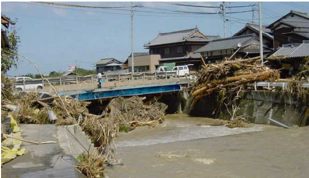
橋脚に集積した流木
