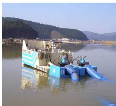
排水ポンプ車(排水能力毎分45m 3 無線操縦自走式)による作業
