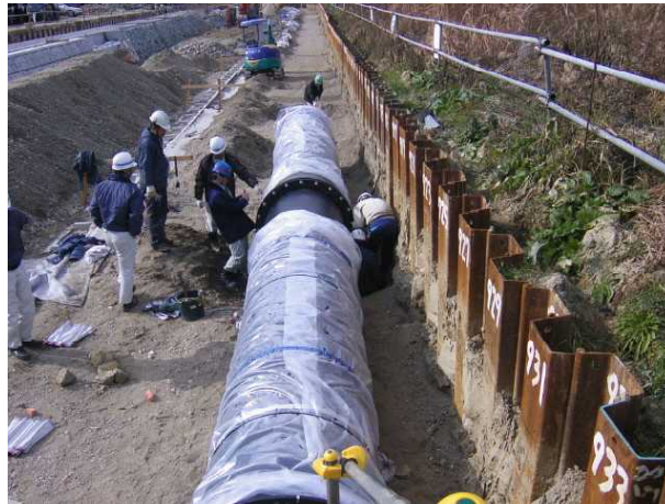
管路の耐震化
