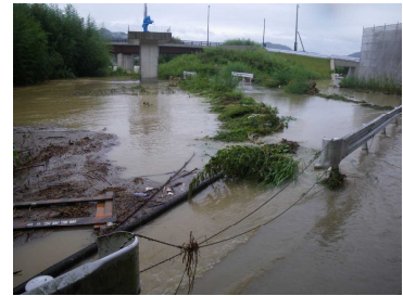
洪水により浸水した道路
