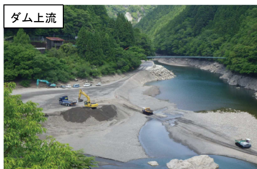
▲堆砂除去状況(平谷箇所)
