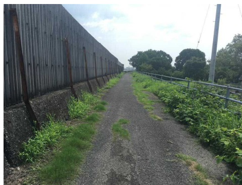
路面状況(舗装の割れ・雑草)
