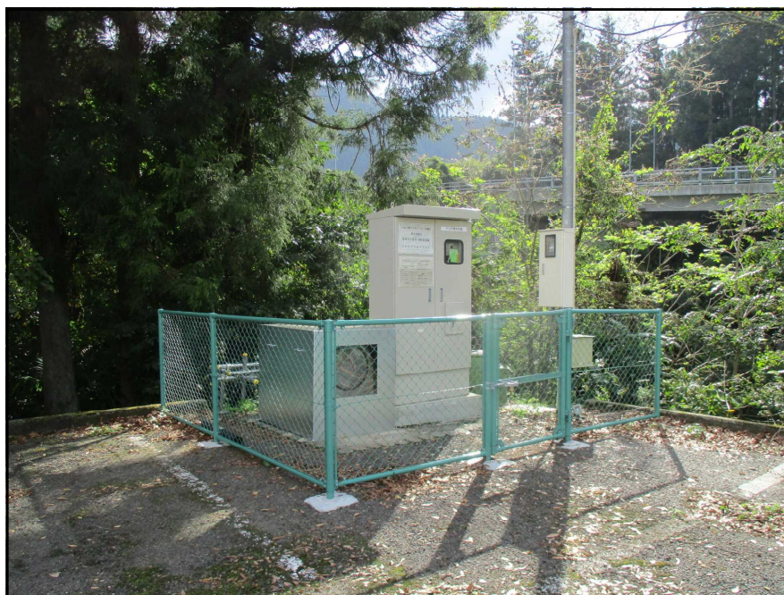
写真1. 木屋平総合支所ピコ水力発電所（R元年10月撮影）
