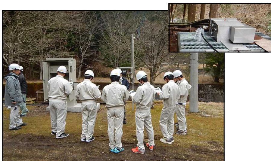
写真2. 木屋平釣り堀ピコ水力発電所（H31年3月撮影、据付け体験時）
