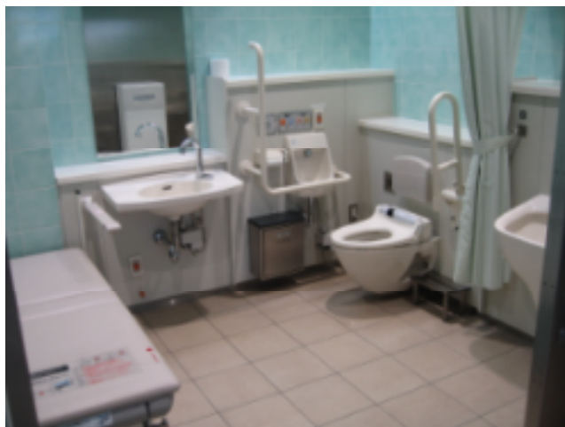
オストメイト、ユニバーサルシートの設置された多目的トイレ
