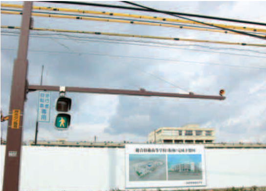
横断歩道の中央に音声誘導装置を設置し、横断方向が認知しやすい工夫をしています
