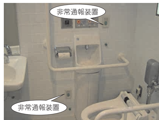
座ったときに手が届く位置と、倒れたときにも手が届く位置に設置された非常通報装置 (郷土文化会館)
