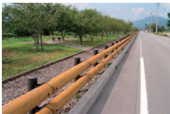
景観に配慮した防護柵の例(津田川島線)
