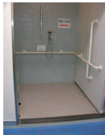
障害者・高齢者等の方でも利用しやすいシャワー室の例 (障害者交流プラザ)
