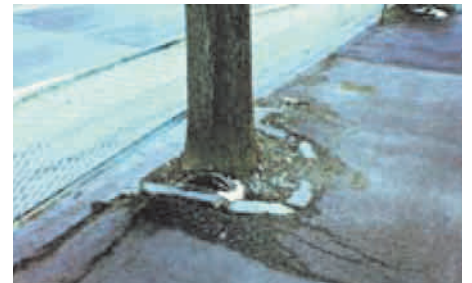
根が張り、舗装を持ち上げている例
