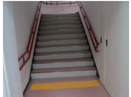
段鼻に滑り止めを設け色別した階段 (障害者交流プラザ)
