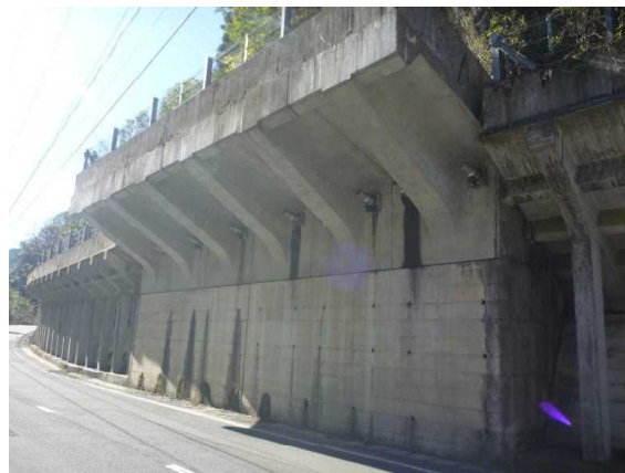
アンカーの防錆油もれ
