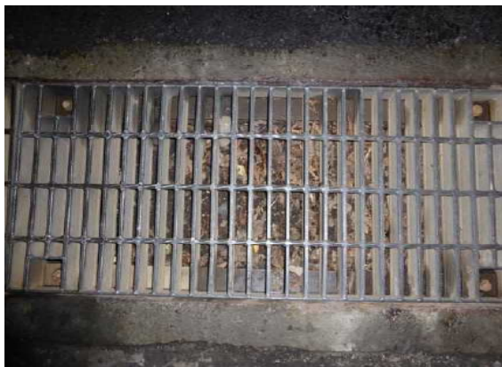
横断側溝内部の土砂詰まり
