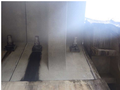
① アンカー防錆油のもれ(左側)
