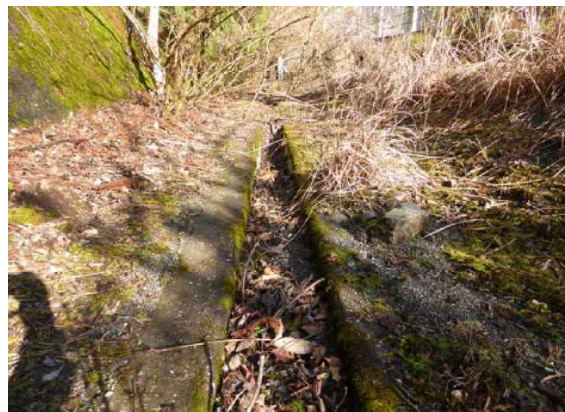
側溝の土砂堆積
