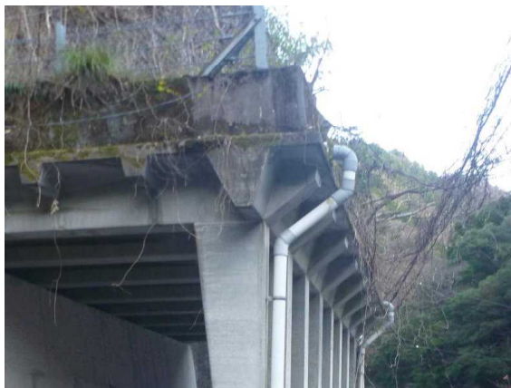
排水管のずれ
