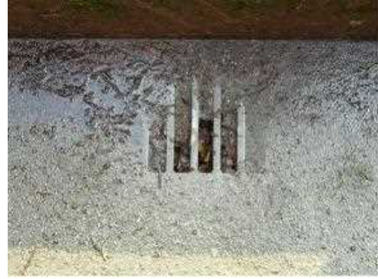
排水柵の土砂詰まり
