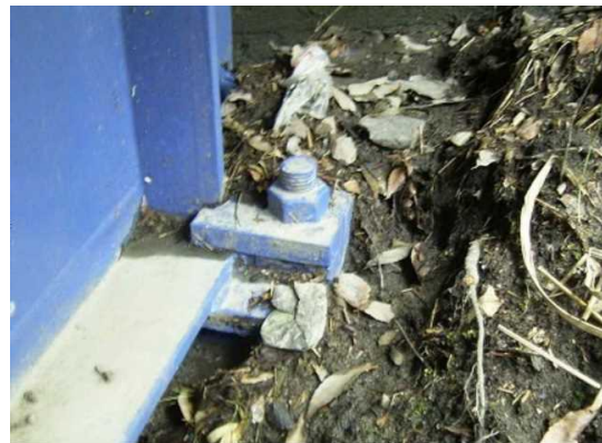
支承の土砂詰まり
