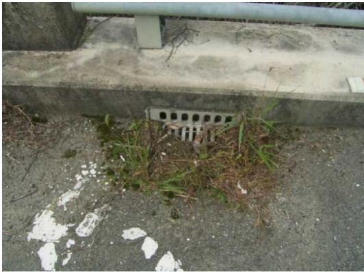
排水柵の土砂詰まり
