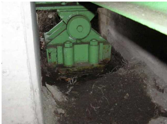
支承の土砂詰まり
