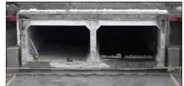
新設六条暗渠 (BOX型)
