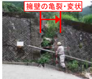
擁壁の亀裂・変状 大規模土砂災害対策 (三好市・有瀬地区)
